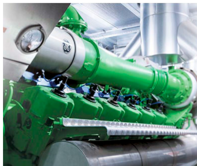
75% des elektrischen Energiebedarfs am Standort Höchst wird über das eigene Erdgas-Blockheizkraftwerk erzeugt.
